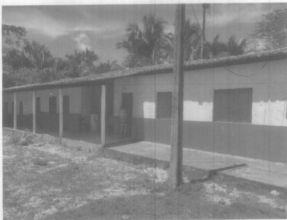
Imagem 1 – pintura da fachada, retalhamento. Fonte: Autora – 2023
