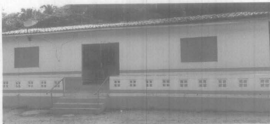
Imagem 1 – pintura da fachada, retalhamento. Fonte: Autora – 2023
